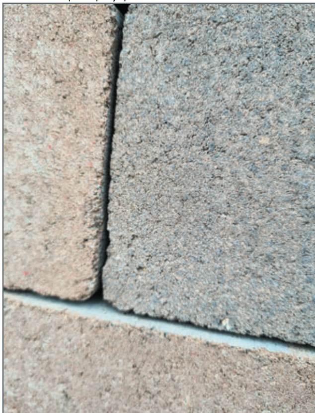
Скол на поверхні тротуарної плитки
