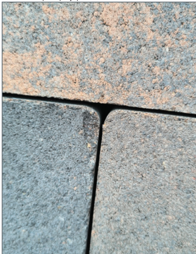
Скол на поверхні тротуарної плитки
