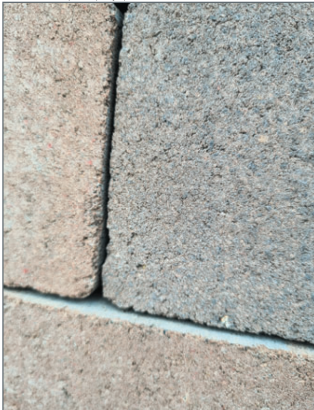
Скол на поверхні тротуарної плитки
