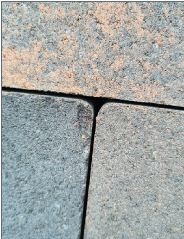
Скол на поверхні тротуарної плитки
