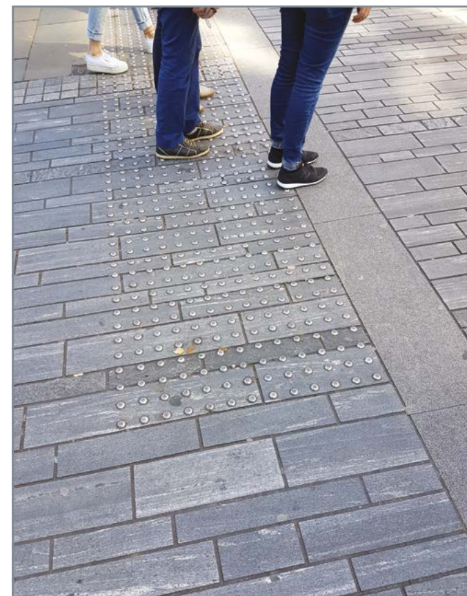
Металлические выступы на плитке для слепых.
