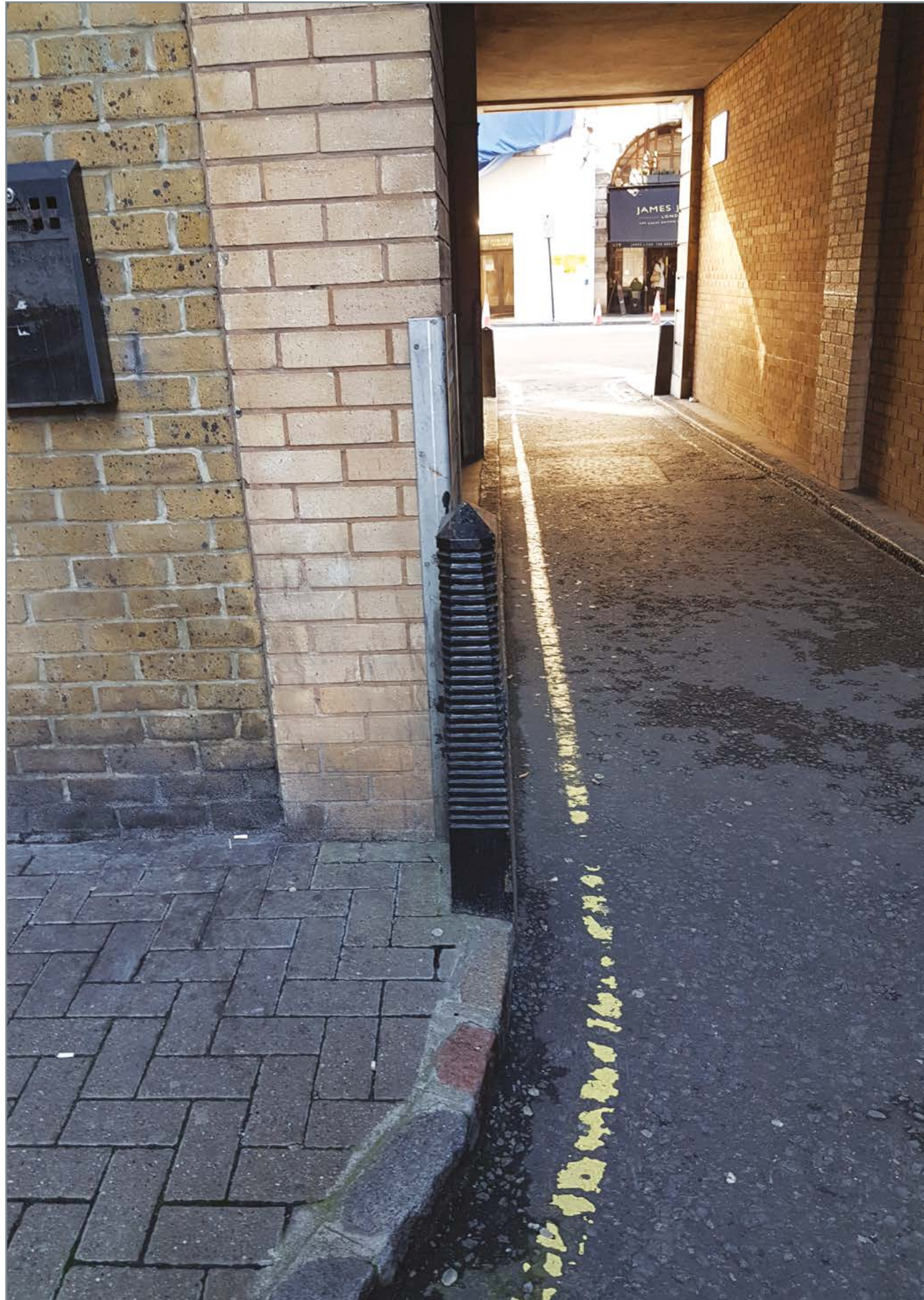
Боллард. Чугун. Забетонирован в тротуар на 30см. Защищает углы дома от повреждений. Ограничивающая и направляющая разметка для транспорта.
